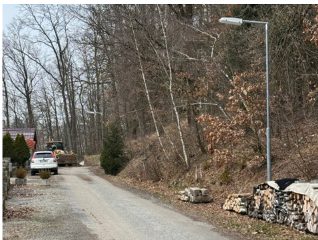
Pokračování ve výměně nevyhovujících zdrojů veřejného osvětlení za zdroje LED
